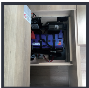
Accessibilité des zones techniques
